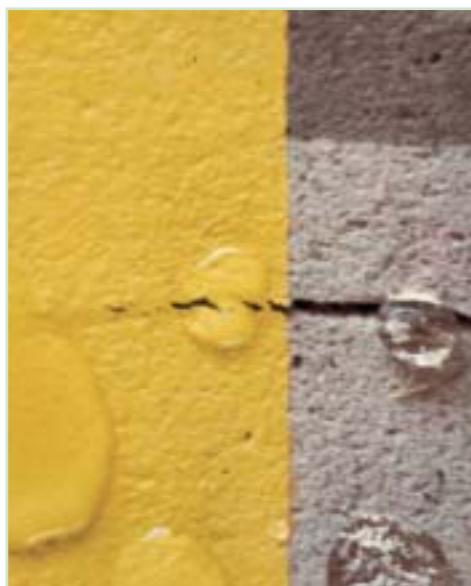
Applicazione di fissativo e pittura con successiva formazione di cavillatura (vista di fronte).
